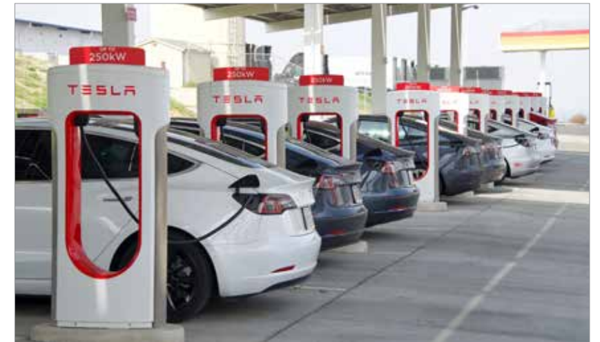
캘리포니아 쇼핑몰 등 곳곳에 설치된 테슬라 수퍼충전기.
